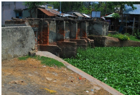
a. Obsolete sluice gate (Polder 25)
