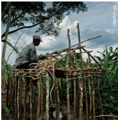
Des réfugiés congolais construisent de nouveaux abris à Rwamwanja, en Ouganda, suite à la reprise des combats dans le Nord-Kivu en 2012.
